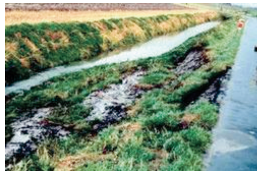
Böschungsschaden durch Bisambefall
